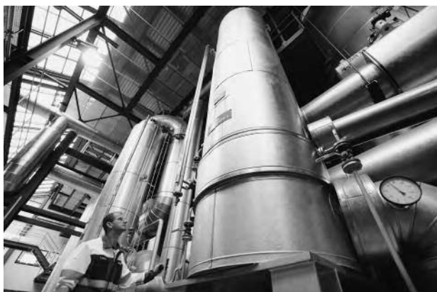
25 Jahre Fernwärme: Modernste Technologie für eine sichere und umweltfreundliche Energieversorgung.
